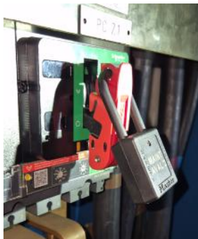
Disjoncteur avec dispositif de verrouillage et cadenas
