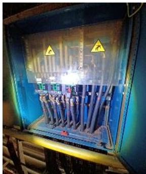
Armoire où a été réenclenché le disjoncteur
