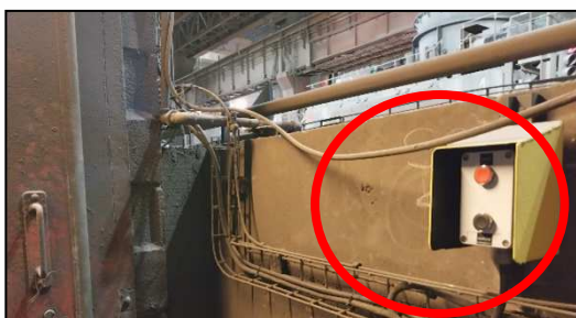
Sous station Vidangeur F91
