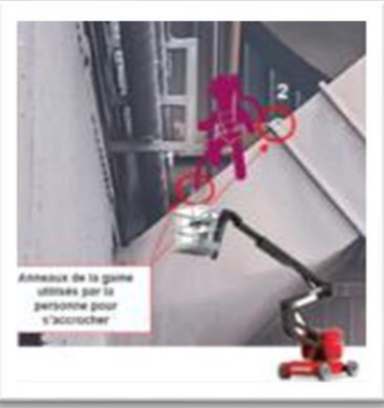
29 Mai 2024 Energie / Dunkerque Conduite gaz 7 mètres Il est sorti de la nacelle (non-respect du MOS)
